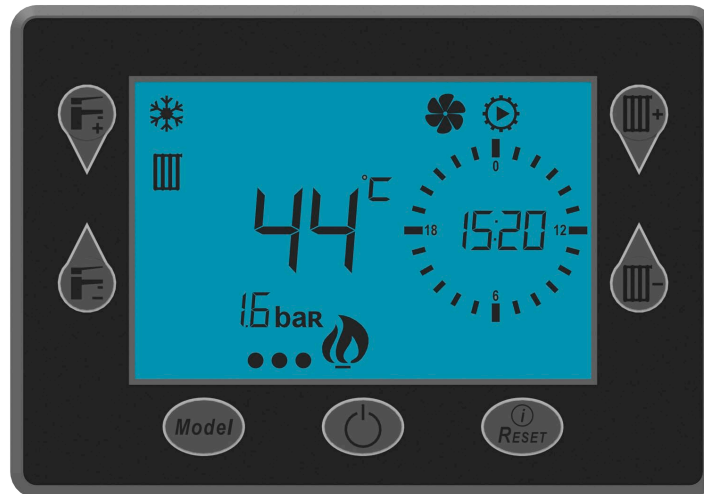
Рис. 2 Панель управления котлом
